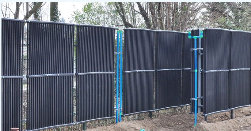
Bild 4. Der Solarzaun grenzt das Grundstück zur Bahnlinie ab.
