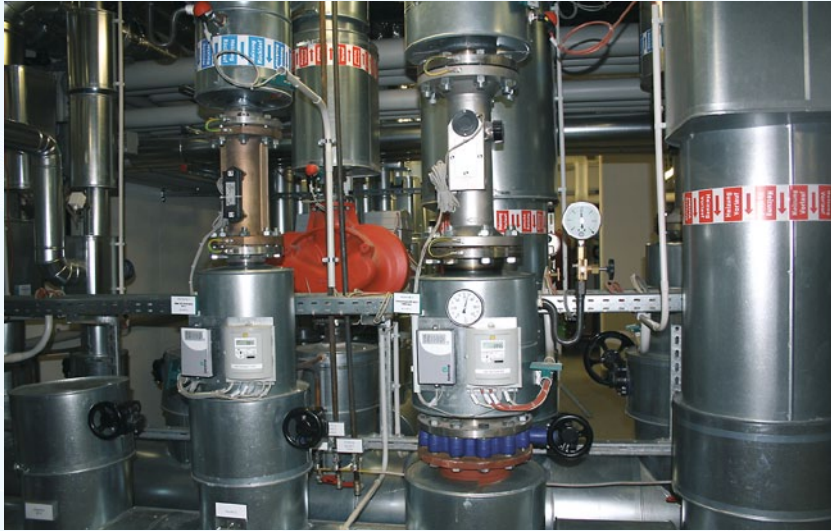
Bild 5. Die Absorberrohre an der Innenwand im Speicher lagern die Solarwärme ein. © Bernd Genath
