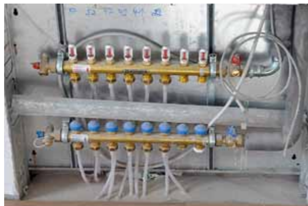
Der Heizkreisverteiler beliefert fast ausschließlich Fußbodenheizungskreise
