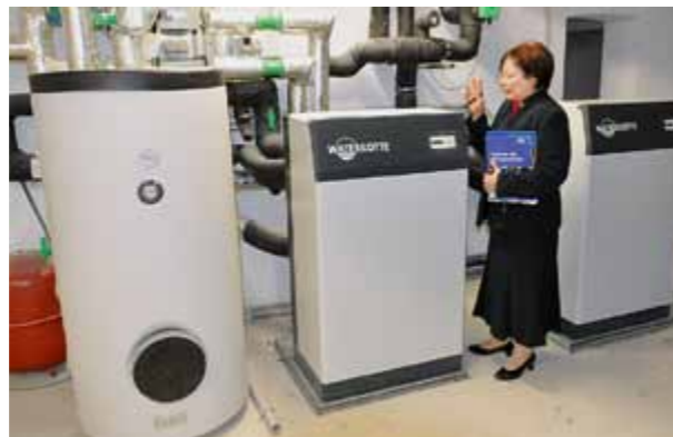
Praktizierte Nachhaltigkeit mit zwei geothermischen Wärmepumpen à 27 kW. Hochschulverband-Mitarbeiterin Jaqueline Güldenring erklärt das Sponsoring
