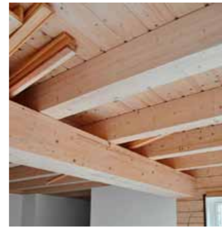
Im Stommel-Haus paaren sich nachhaltiges Baumaterial und nachhaltige Heiztechnik
