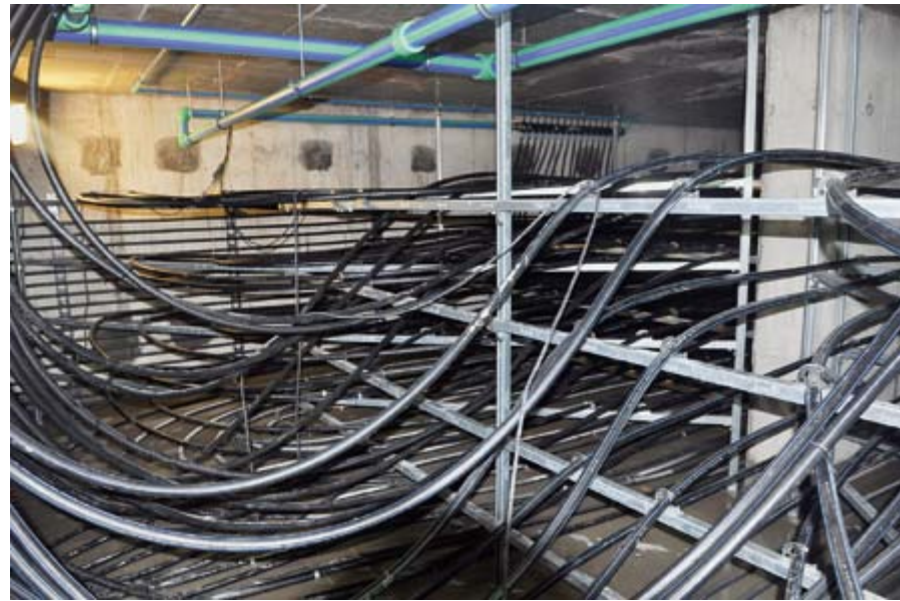
11 km PE-Rohr (25 mm Durchmesser) entladen jeden der beiden Eisspeicher mit 350 m 3 Wasserinhalt
