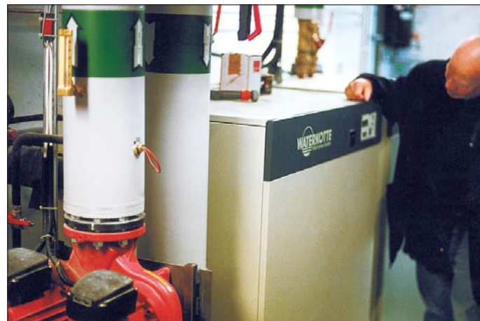
Maximale Leistung 145 kW je Aggregat. Im Keller stehen zwei dieser Maschinen.
