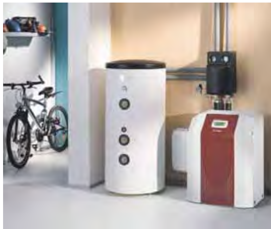
Eine Wärmepumpenanlage nimmt im Keller nicht mehr Platz ein als etwa eine Ölheizung. Und sie benötigt keinen Tank! Foto: Dimplex
