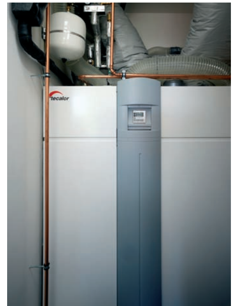
■ Mit Weitblick agierte der Architekt bei der Haustechnik und empfahl den Einsatz moderner Wärmepumpentechnologie kombiniert mit kontrollierter Lüftung.
